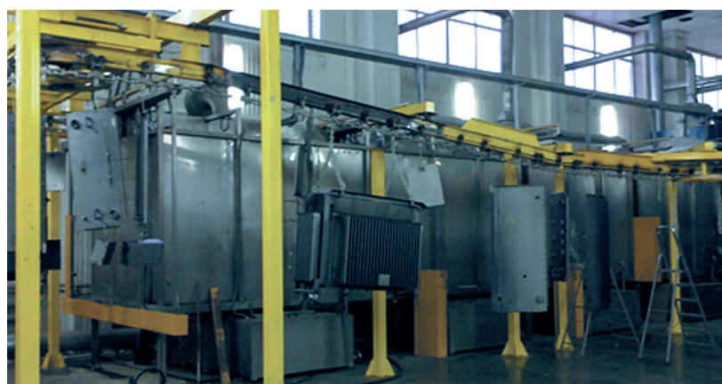
Участок по сушке баков трансформаторов
